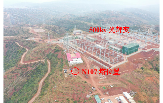
进线端 (500kv 光辉变)
