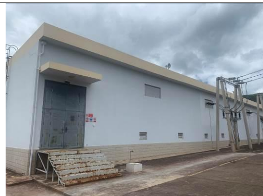
35kV配电装置室
