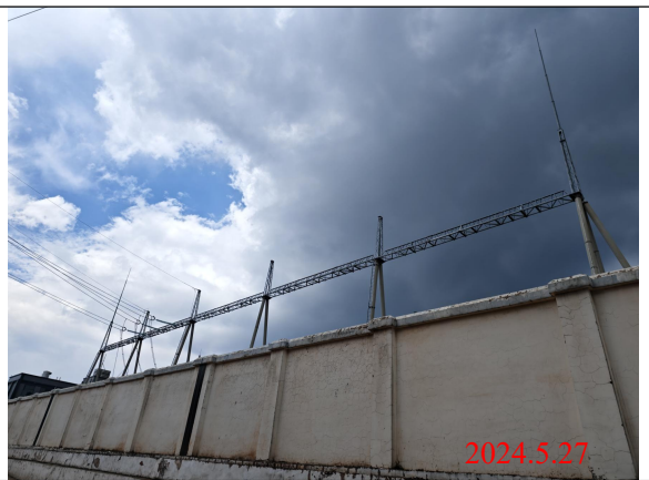
保顶山风电场出线端（终点）
