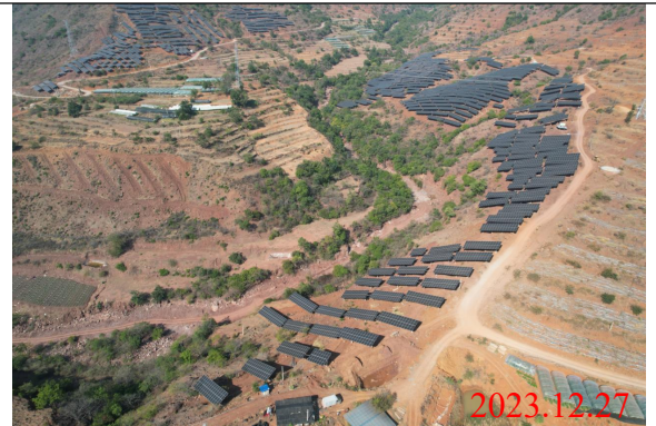
4#光伏发电区（已批已建设地块、局部）
