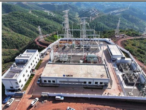
弥兴光伏220kV升压站现状（已建）
