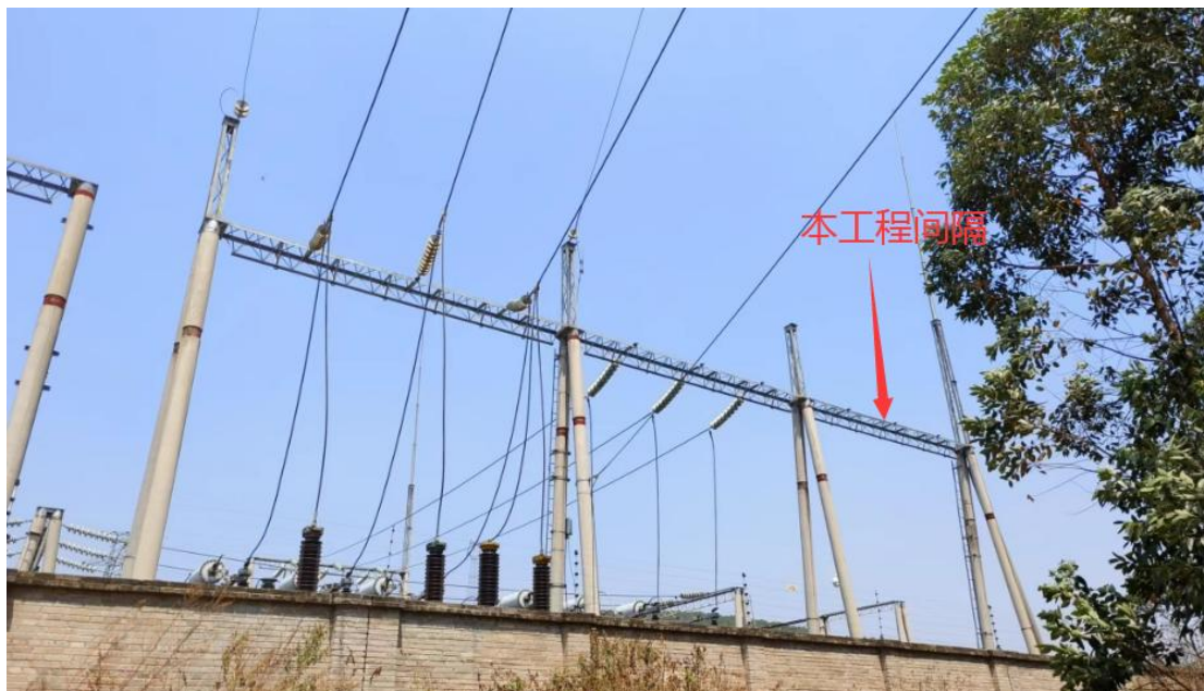
图 2.2-2 110kV 上营变 110kV 出线实景
