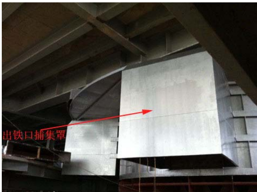
图4.3-1 同类项目渣铁排放半密闭集气罩现场照片
