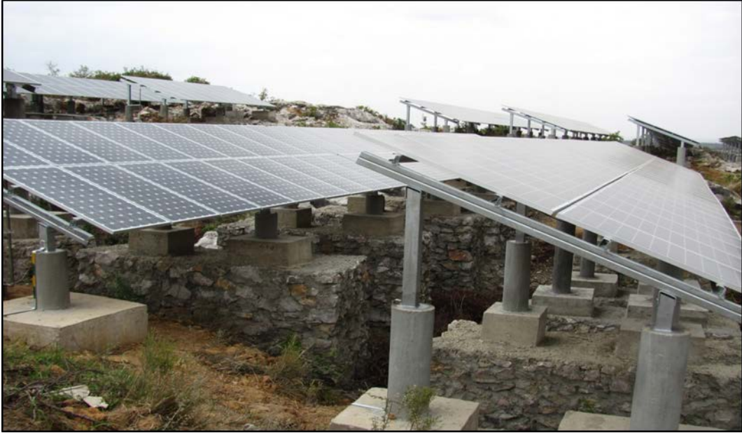
图 2.2-1 固定式安装运行方式
