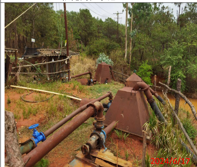
依托 3 台尾矿库回水泵
