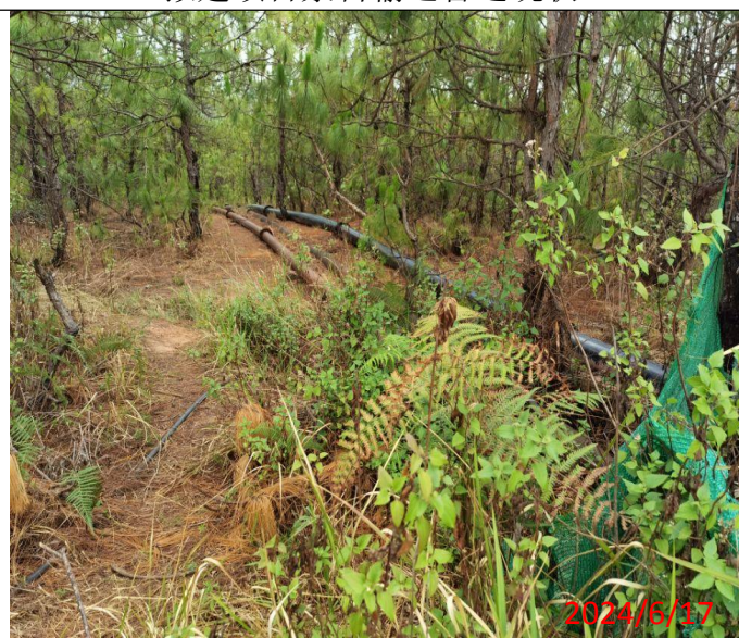
依托回水管道现状
