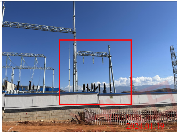
物茂光伏 220kV 升压站本项目预留接口
