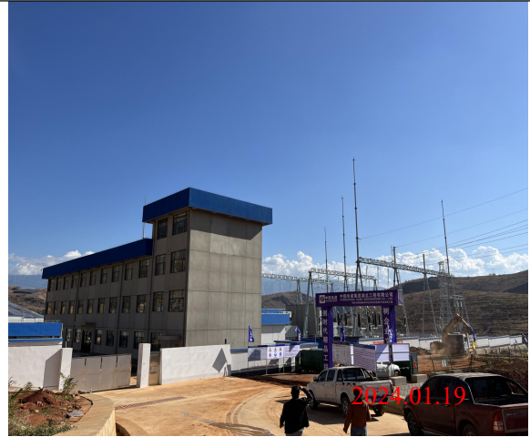
物茂光伏 220kV 升压站现状
