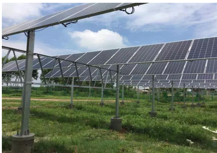
图 2-2 固定式安装运行方式
