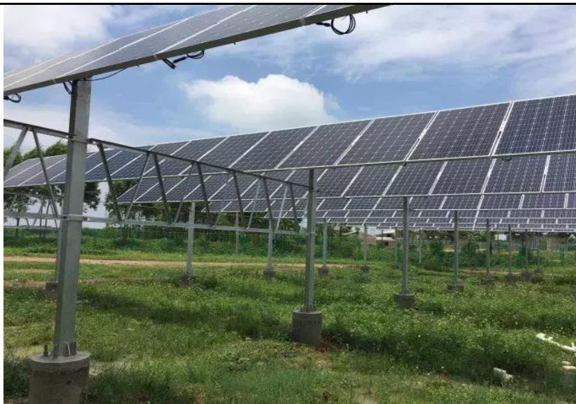
图 2-3 固定式安装运行方式
